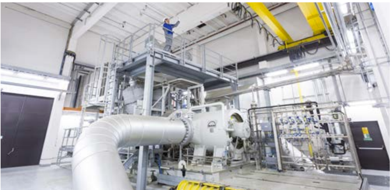
Abb. 5 Krananlage in einer Gas-Verdichteranlage
