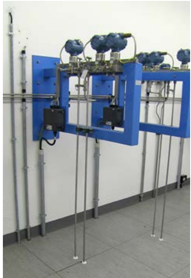
Abb. 41 Messumformerraum mit aufgeständertem Plattensystem-Fußboden (ableitfähig)
