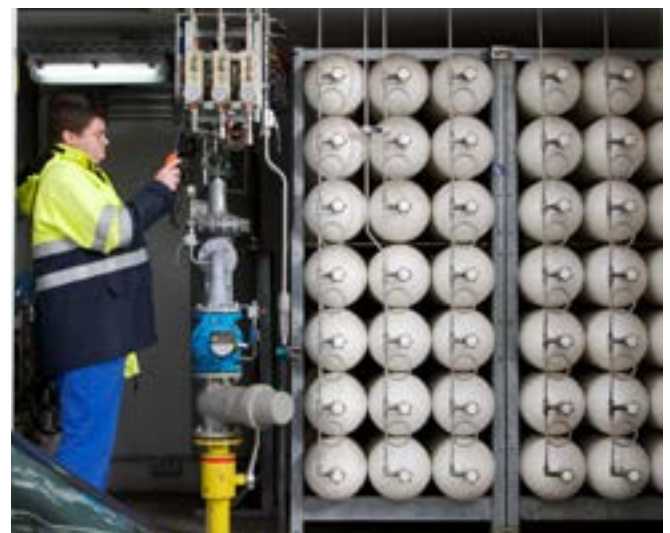
Abb. 17 Speicherflaschen in einer Erdgastankstelle
