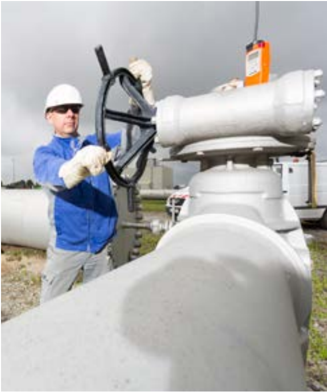
Abb. 9 Schließen einer Absperrarmatur
