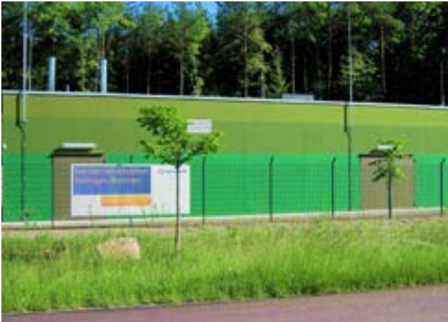
Abb. 14 GDRM-Anlage in einem Gebäude untergebracht
