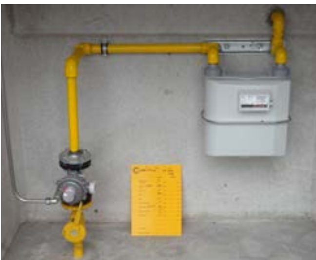
Abb. 16 Gas-Druckregelung im Netzanschluss
