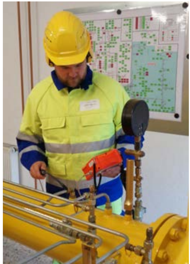
Abb. 28 Dichtheitskontrolle bei der Funktionsprüfung an einer GDRM-Anlage.
