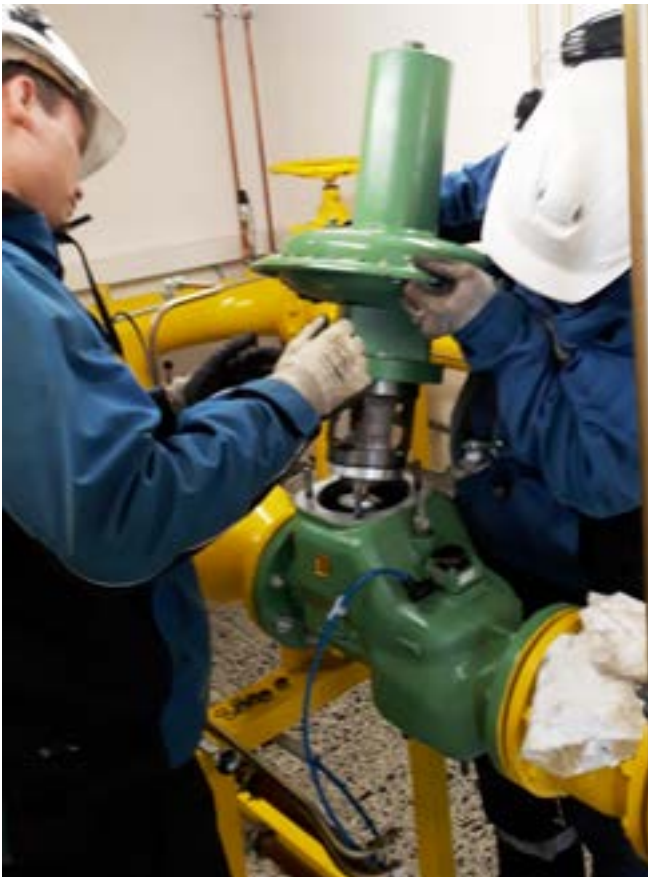
Abb. 11 Wartung eines Regelgerätes
